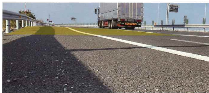
舗装損傷現況
