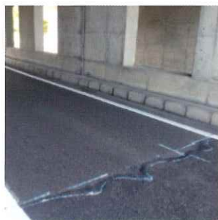
舗装損傷現況
